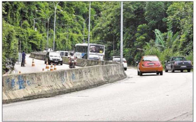
■ CENA COMUM: o trânsito é desviado para operários trabalharem na recuperação da estrada
